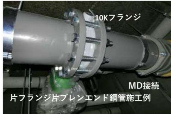
キャパシタ弁とDVLP配管の接続に使用
