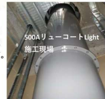
高層ビルの大口径臭突管
